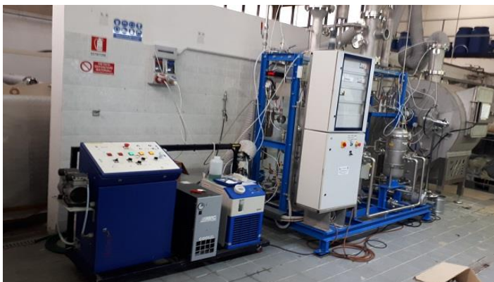
Foto: impianto MINOSSE (generatore NTP – colonne di assorbimento – reattore di contatto)
